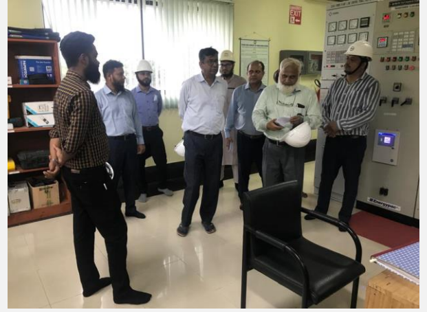
পিজিসিবি ২৩০/১৩২ কেভি খুলনা সাউথ সাবস্টেশন পরিদর্শন
