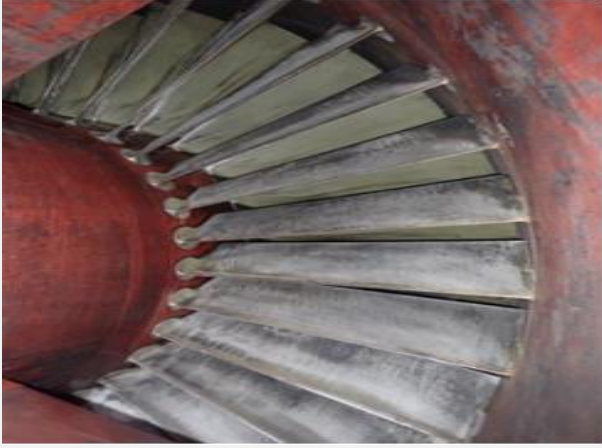
চিত্র ১.১: IGV inspection
