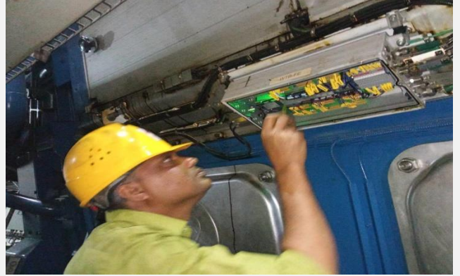
চিত্রঃ Engine এর sensor সমূহের connection tightness check করা হচ্ছে
